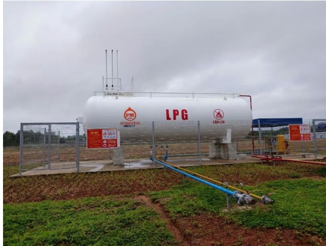
Hình 1.4. Hình ảnh bồn chứa gas của dự án
