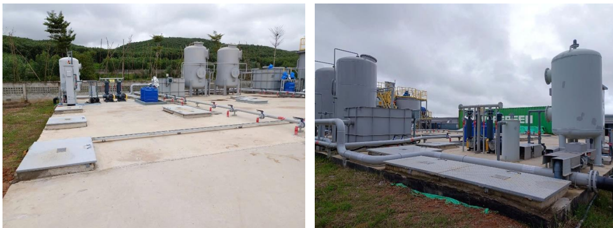
Hình 3.13. Hình ảnh hệ thống xử lý nước thải sinh hoạt của dự án
