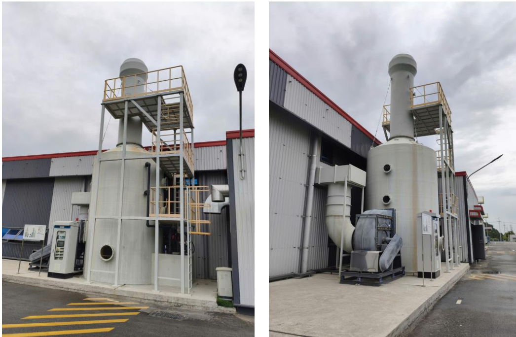
Hình 3.24. Hình ảnh hệ thống xử lý khí thải phát sinh từ công đoạn mạ Niken (Hệ thống số 2)
