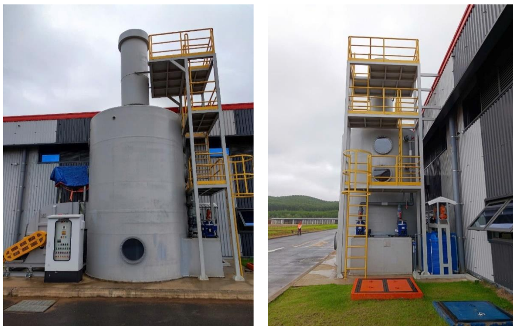
Hình 3.23. Hình ảnh hệ thống xử lý khí thải phát sinh từ công đoạn mạ Niken (Hệ thống số 1)
