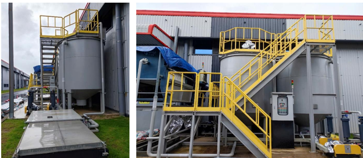
Hình 3.8. Hệ thống xử lý sơ bộ nước thải mài, đánh bóng
