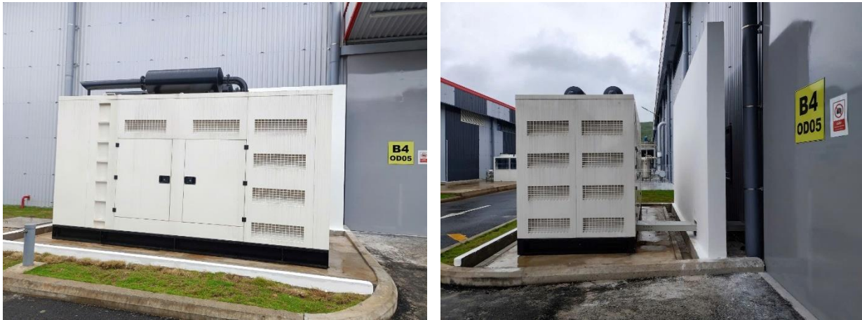
Hình 3.37. Máy phát điện dự phòng
