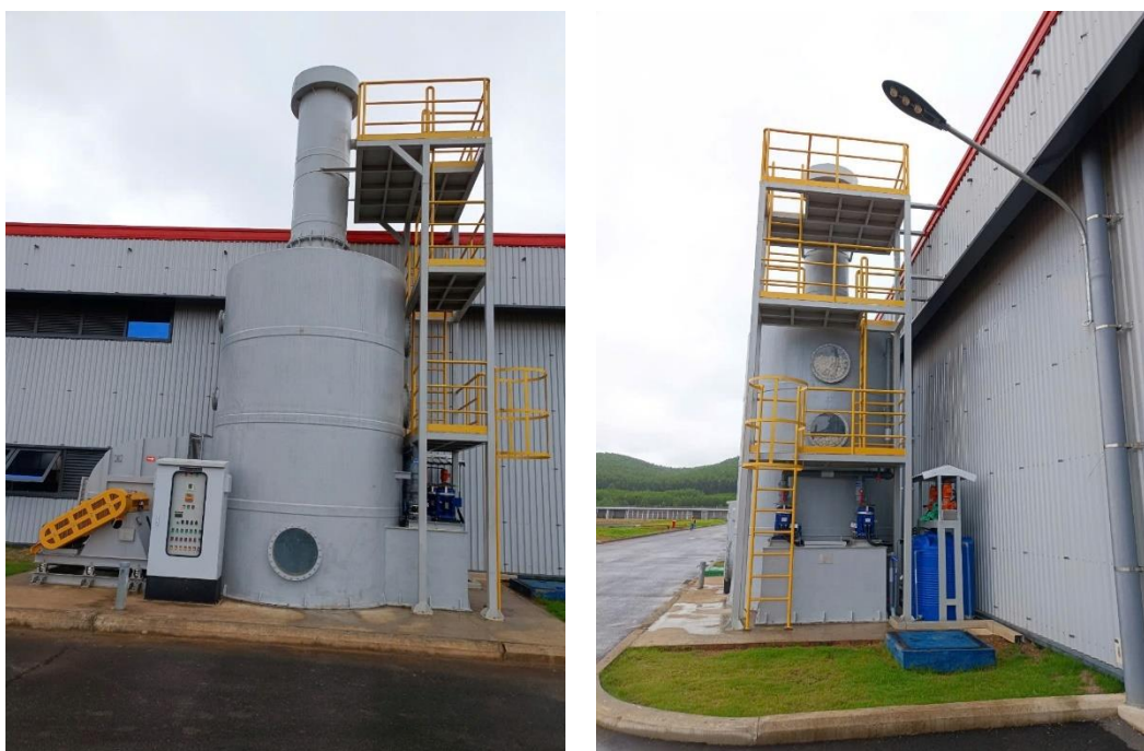
Hình 3.26. Hình ảnh hệ thống xử lý khí thải phát sinh từ công đoạn phủ photphat
