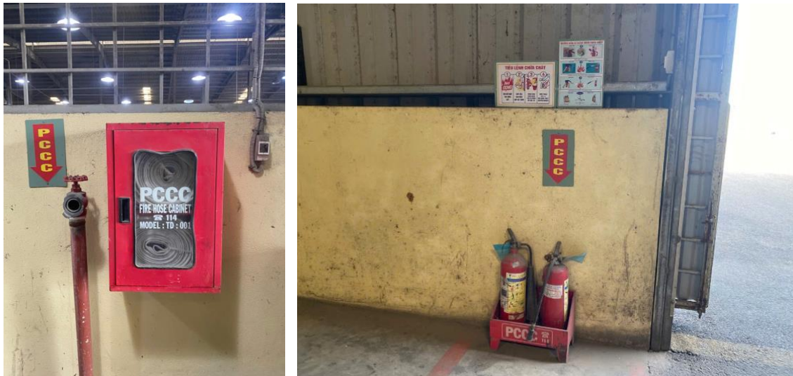
Hình 2.3. Thiết bị PCCC tại Cơ sở
